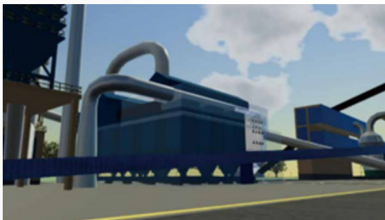
Rauchgasentstaubungsverfahren im Zementwerk
